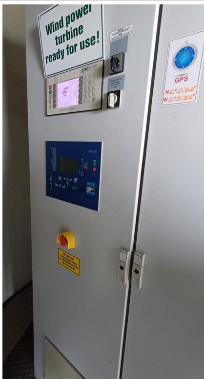
Armario de comunicaciones. Dentro del habitáculo se encuentra el interruptor seccionador del generador. Ground cabinet controller. Inside we can find the generator circuit breaker.
