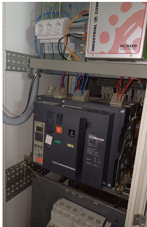
Seccionador interruptor en posición OFF. Circuit breaker in OFF position.
