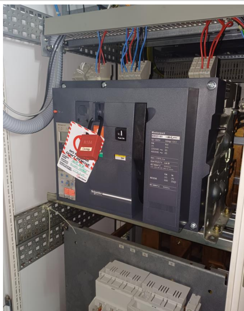
Seccionador interruptor en posición OFF, con la pestaña extraída y el candado LOTO instalado. Circuit breaker in OFF position, with tab removed and LOTO padlock installed.
